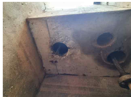
<유입밸브실(1지) 상부슬래브 파손>
