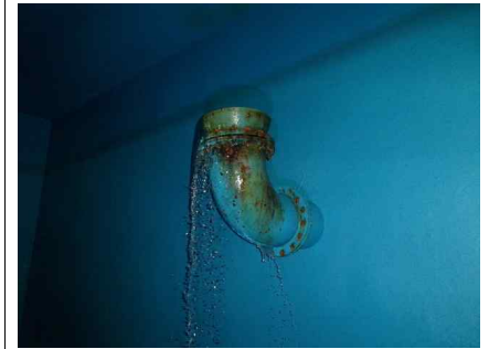
<1지 유입배관 관부식 및 차수불량>
