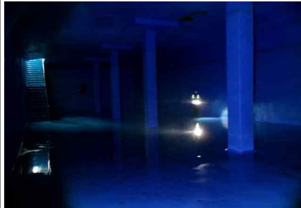
<배수지 2지 전경>
