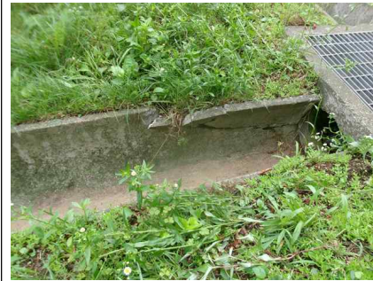
<배수시설 배수로 파손>
