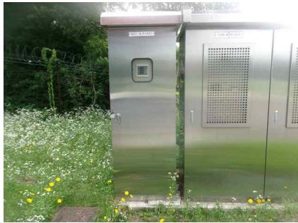
<외부 현장제어반 상태양호>
