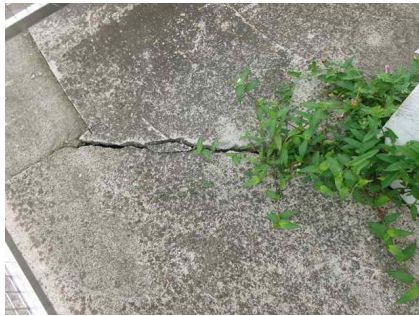
<계단실 외부 바닥 균열>
