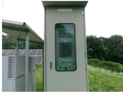
<전기실 전기설비 상태양호>
