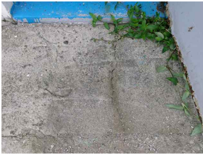
<계단실 외부 바닥 균열>
