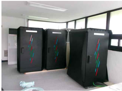
<관리동 내부 전기설비 상태양호>
