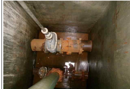
<기계설비(밸브 및 배관) 전경>
